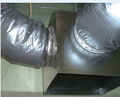
老人ホーム <空調用ダクト> TB-4M タイロン巻バンド
